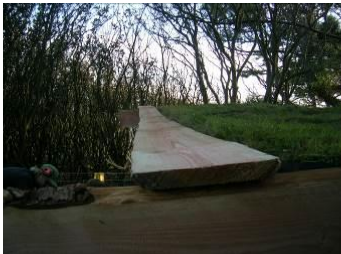
Her er sternbrættet lagt op på vindskederne til afsætning af længden på det.
